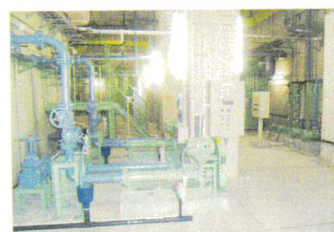
日本下水道事業団 福岡浄化センター
