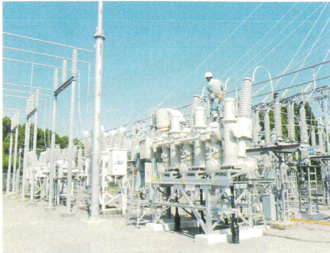
九州電力 高尾野変電所
