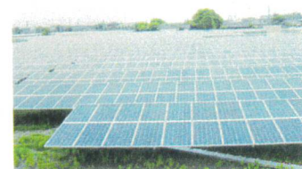
太陽光発電設備
