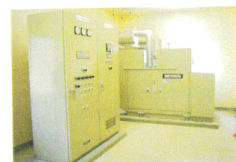
簡易水道施設電気設備
