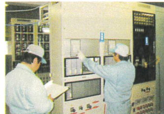
九州電力 鹿児島変電所
