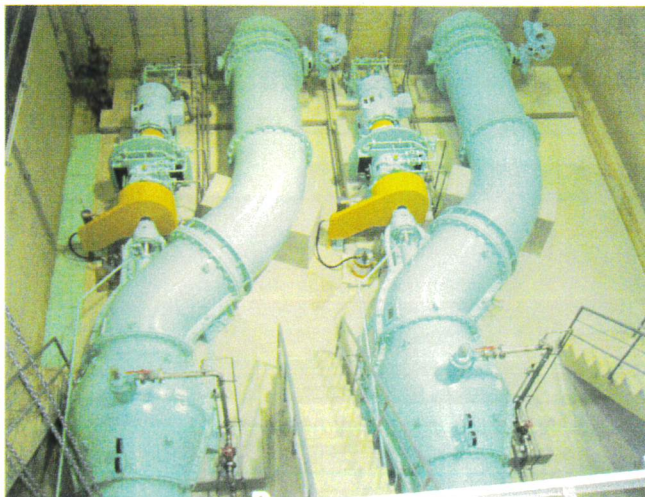
中村排水機場
