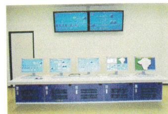
日南市 飢肥浄水場
