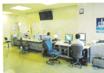
薩摩川内市 丸山浄水場
